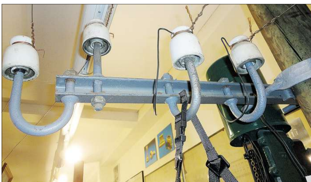
Porzellanisolatoren einer Überlandleitung.
