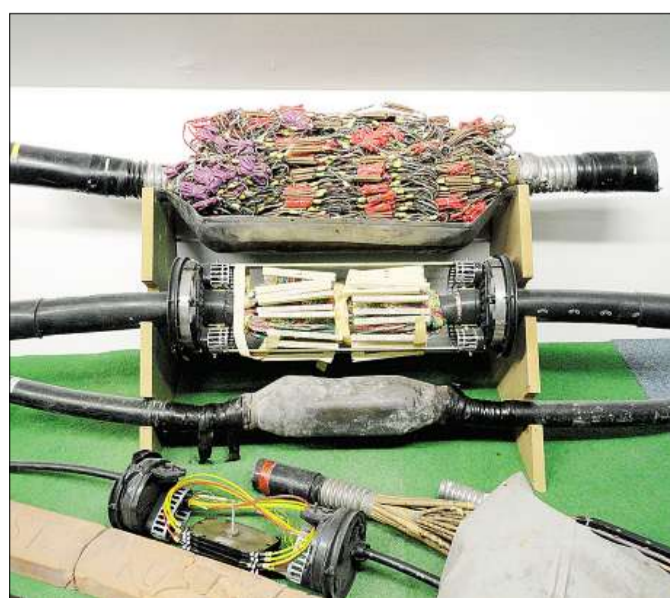
Verbindungsmuffen einer unterirdisch verlegten Telefonleitung.
